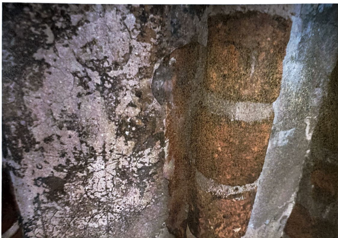
Fot. 4. Toruń, kościół WNMP, szczyt wschodni, 1 kondygnacja pomiędzy wieżą środkową a południową, warstwy barwne pod tynkami z rytami, w czasie prac konserwatorskich w 2018 r.
