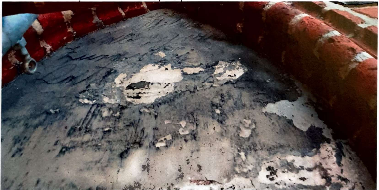
Fot. 3. Toruń, kościół WNMP, zakrystia, szczyt wschodni, blenda po stronie południowej, zaprawy cementowe, inskrypcja, przed pracami konserwatorskimi w 2018 r.
