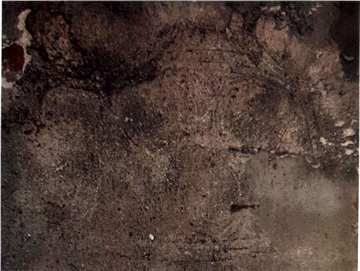
Fot. 2. Toruń, kościół WNMP, zakrystia, strona północnowschodnia, blenda po stronie północnej, uzupełnienia cementowe, przed pracami konserwatorskimi w 2018 r.
