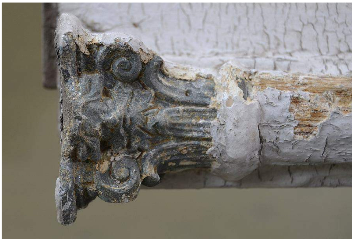
Il. 16 Toruń, Kamienica przy ul. Rynek Staromiejski 18 - pierwotna stolarka okienna – widok na częściowo oczyszczoną głowiczkę cynową
