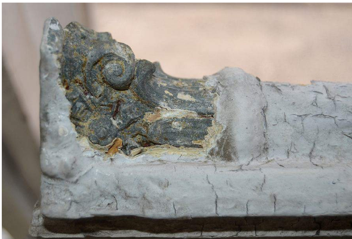
Il. 17 Toruń, Kamienica przy ul. Rynek Staromiejski 18 - pierwotna stolarka okienna – widok na częściowo oczyszczoną głowiczkę cynową
