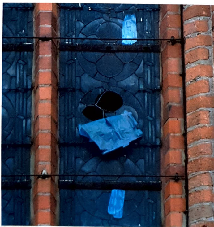
Fot. 12. Fragment okna nII z widocznymi prowizorycznymi zaklejeniami ubytków szkła taśmą klejącą.
