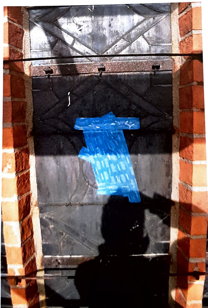
Fot. 8. Prowizoryczne zaklejenie taśmą ubytków szkła w kwaterze.
