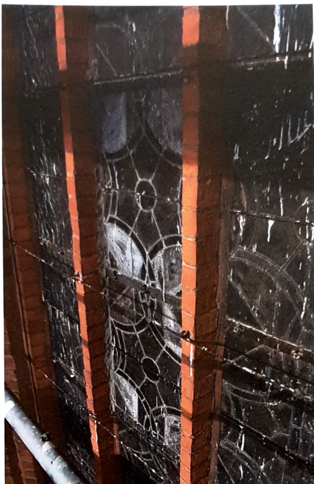
Fot. 9. Fragment okna z widocznymi zabrudzeniami i uszkodzeniami szkła. Na kwaterach poddanych wcześniejszym naprawom zauważyć można produkty korozji patyny w postaci białych nalotów. Fot.
