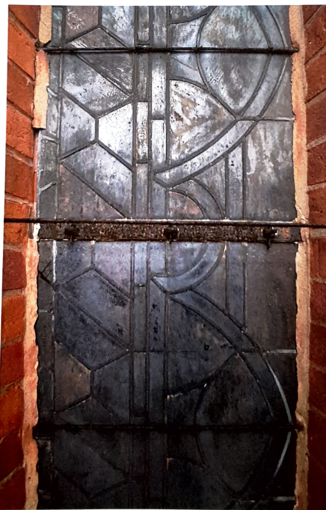
Fot. 6. Fragment okna z widocznymi zabrudzeniami, pęknięciami szkła, patyny oraz skorodowaną laszą i wiatrownicami. Po bokach ubytki zaprawy uszczelniającej.
