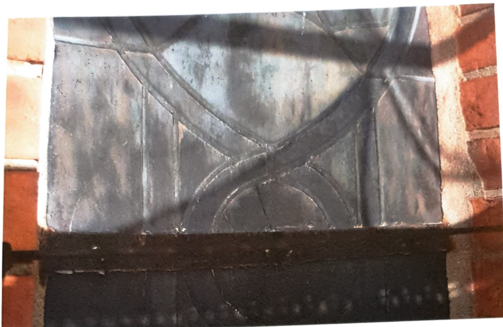
Fot. 7. Kwatera z widocznymi zabrudzeniami, uszkodzeniami szkła, iryzacją patyny oraz korozją laszy i klinów.
