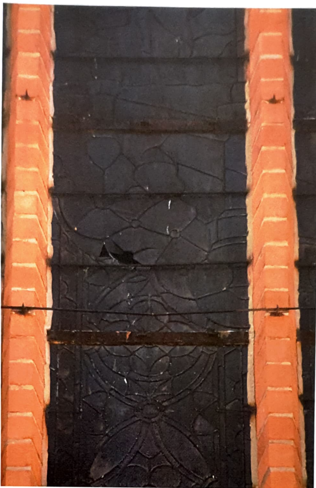
Fot. 11. Fragment kwatery okna wschodniego nr I z widocznymi ubytkami szkła, zabrudzeniami i skorodowanymi laszami oraz wiatrownicami.
