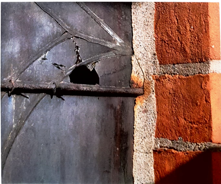
Fot. 10. Ubytek i pęknięcia szkieł.
